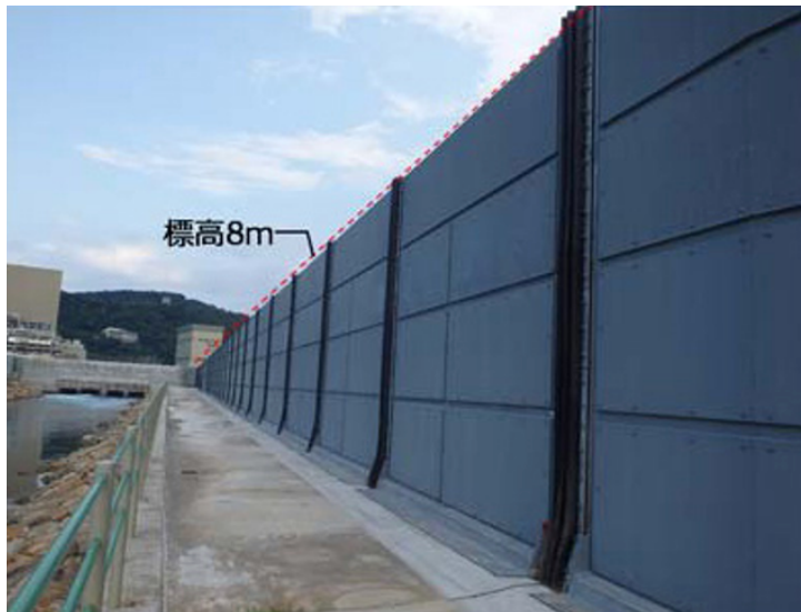
다카하마 원전의 방파제
